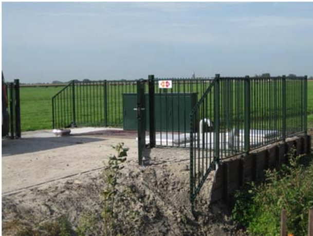
Ondergrondse opstelling met bovengrondse schakelkasten
